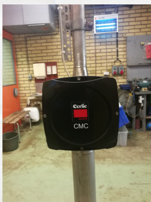
Bilden visar slamhaltsmätaren monterad på slamledningen.
