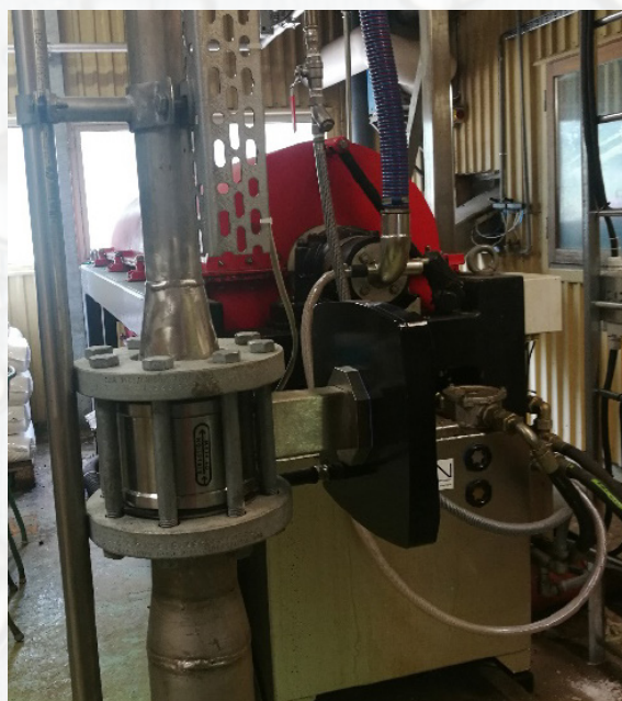
Bilden visar slamhaltsmätaren monterad på slamledningen innan centrifugen, som syns i bakgrunden.
