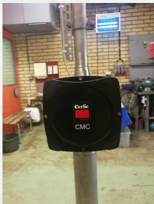
Bilden visar slamhaltsmätaren monterad på slamledningen.
